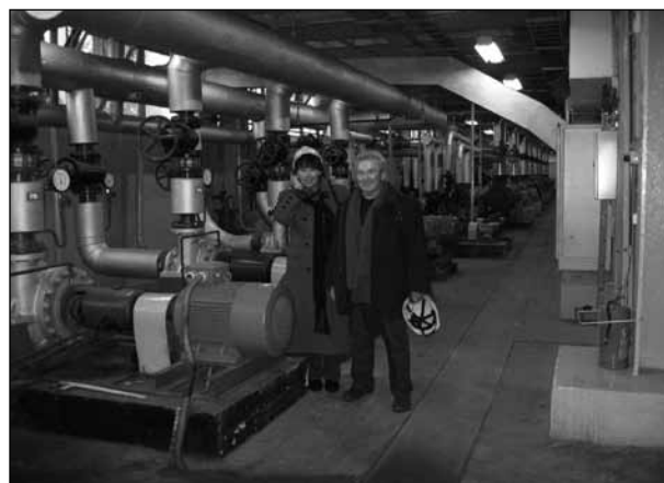
W przepompowni kol. Grażyna Królak i kol. Zygmunt Frąk
